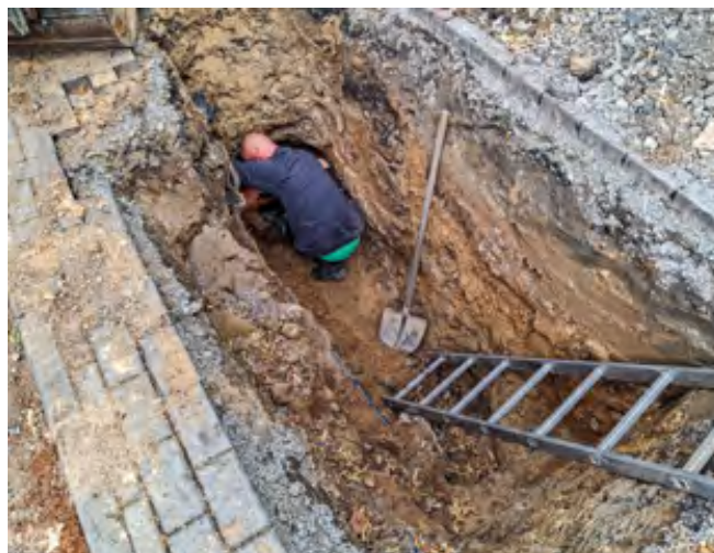
Pan Pavel z TS při odkrývání havárie kanalizace
