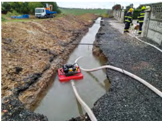
Voda zaplnila celý výkop
